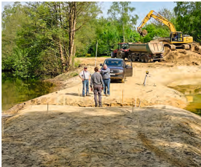
Weiter geht's! Der Abtransport des Erdreichs beginnt und die Feinplanung wurde in Angriff genommen.
